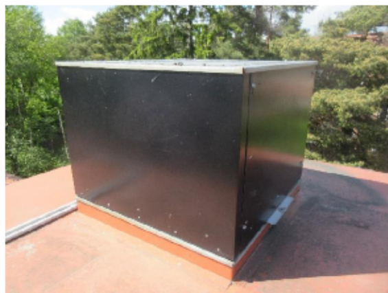
En av frånluftsfläktarna
