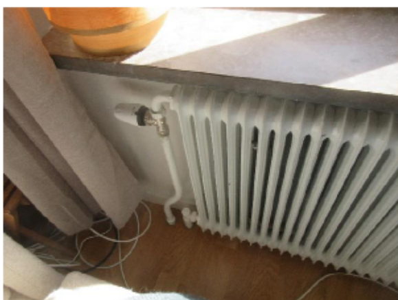
Nya termostatventiler på original radiator
