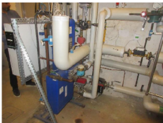
Undercentral för värme och varmvatten
