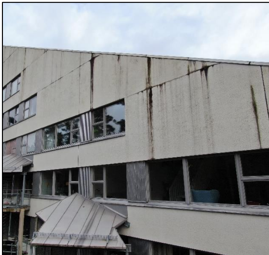
Fasad med algpåväxt och rinningar
