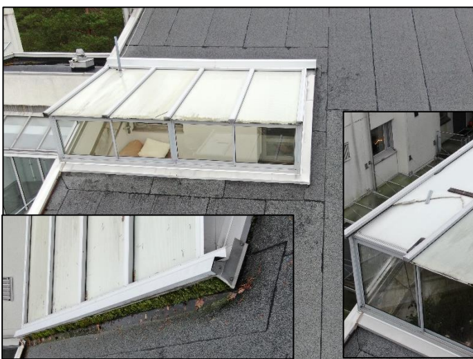
Takbalkong samt dåligt fall/mossa
