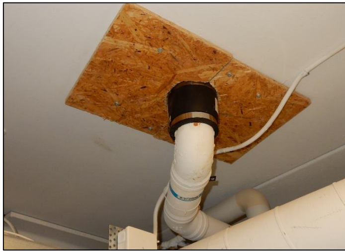
Tidigare läckage/skada avloppsledning
