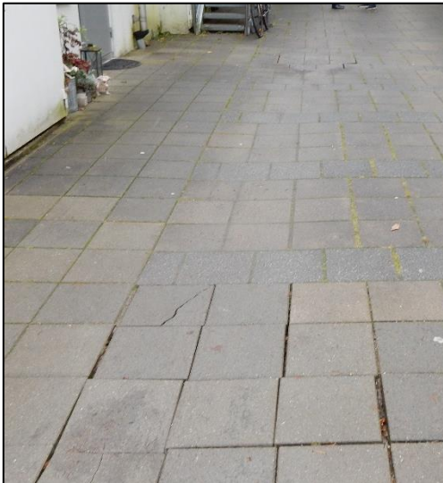
Stenbeläggning med sättning och skador
