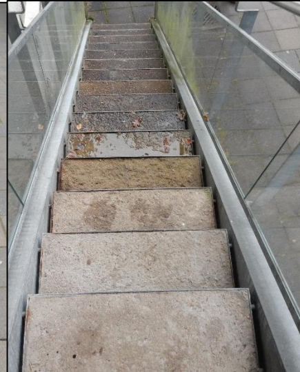
Trappsteg med skador
