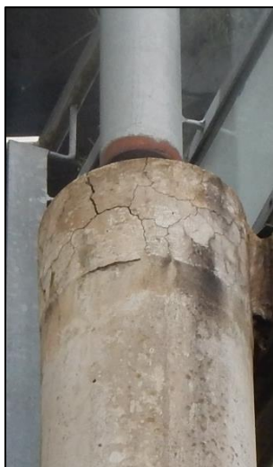
Balkongpelare med skador
