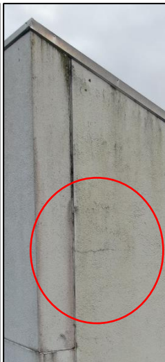
Mindre spricka i fasad
