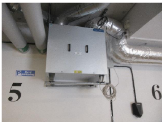
Ventilation av garaget
