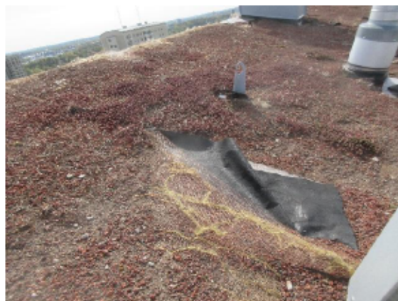
Sedumtak som lossar
