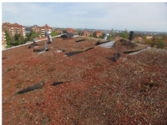
Sedumtak som är skadat
