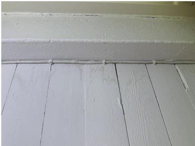
Missfärgning/fuktfläckar ovan dörr i groventré
