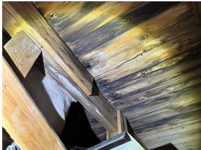
Spår av läckage i underlagstak vind
