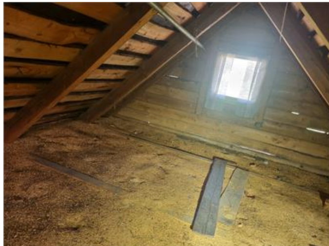
Översiktsbild, vind med otätheter i fasad.
