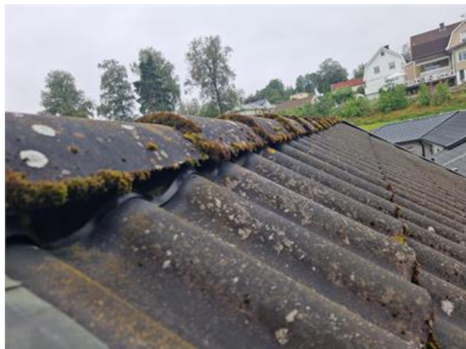
Begynnande mosspåväxt på takpannor
