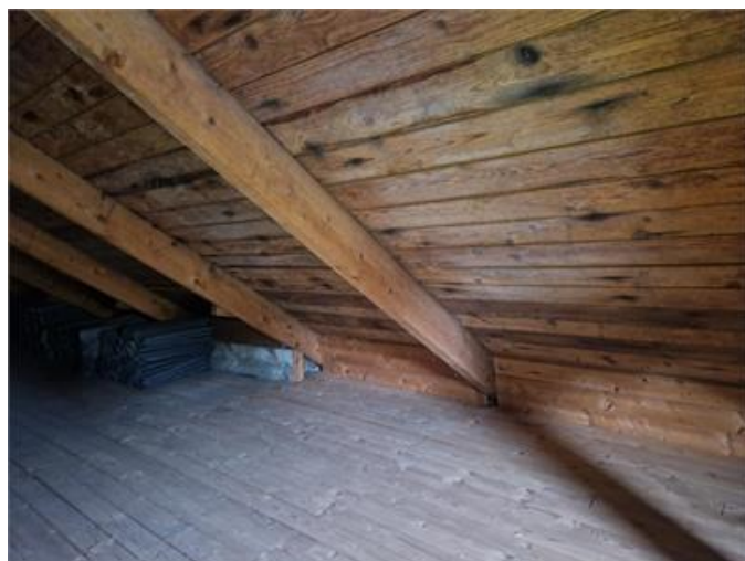
Fukt och mikrobiell påväxt noterades på underlagstak (se även under takkupa)
