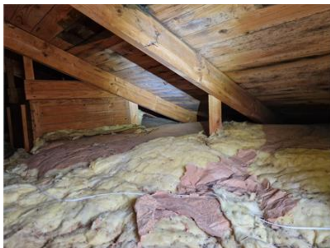
Vy på delar med fukt/mikrobiell påväxt
