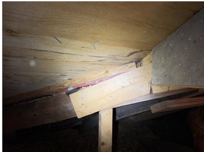
Exempel på spår av läckage i underlagstak
