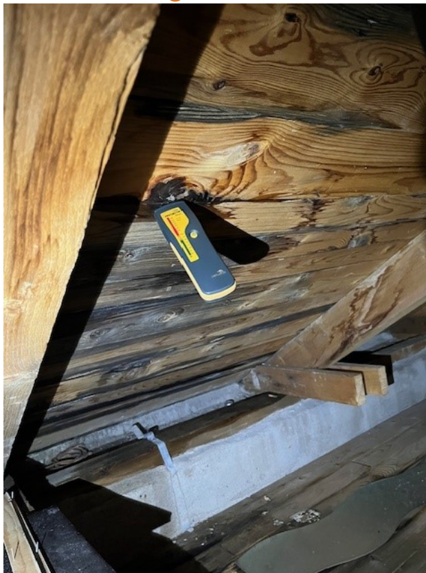
Fuktmätning i snedvind vid pågående läckage.
