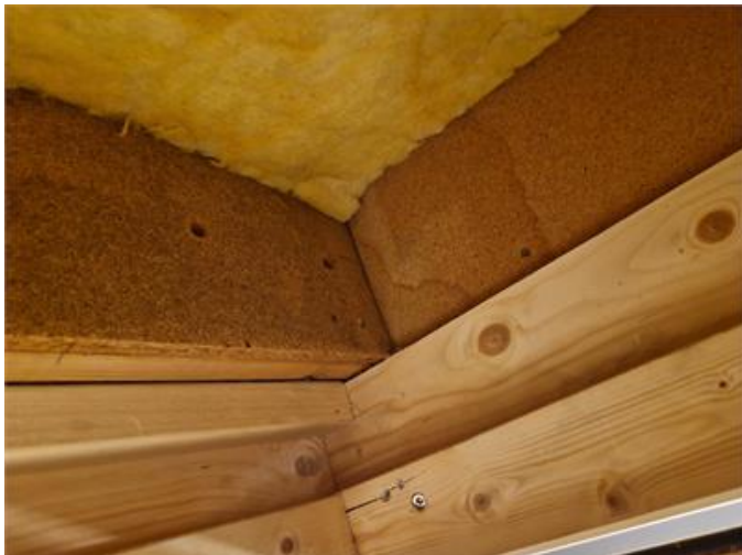
Äldre kondens/fuktfläck i takluckans konstruktion
