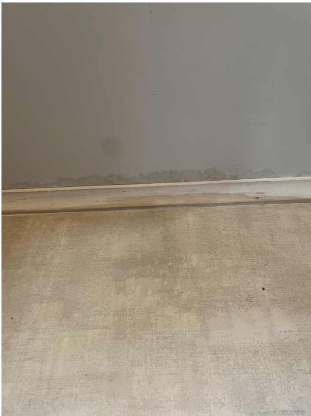
Figur 2. Missfärgning i takvinkel i badrum
