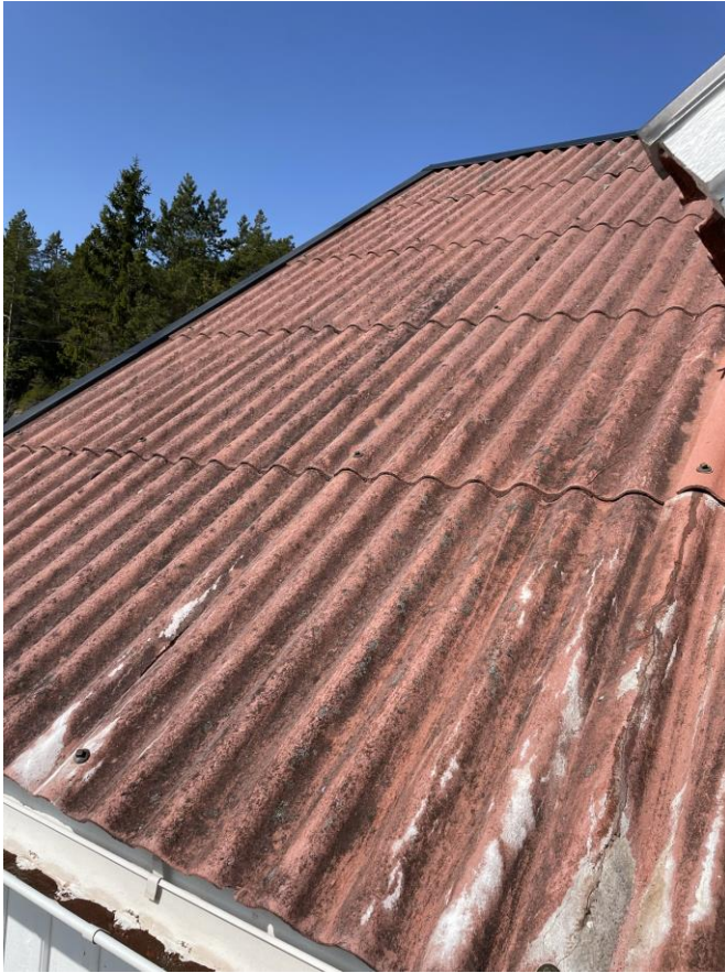
Figur 3. Sprickor i takpannor.
