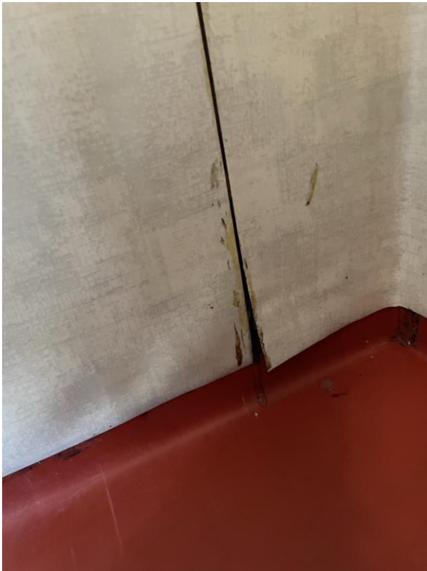
Figur 1. Skada i tätskikt badrum.
