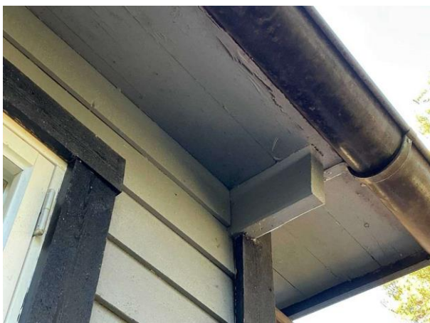
Bild 7: Utvändigt, Yttertak, Hängränna bör riktas Mossa noterades på tak, mossor är fukthållande och kan orsaka skador på takkonstruktionen (rensa) Täckplåt vid skors...
