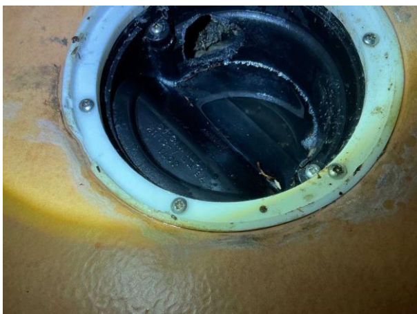
Bild 9: Invändigt, Källarplan, Badrum, Äldre våtrum se riskanalysen Oklart utförande på underliggande betongplatta Missfärgningar och mikrobiell påväxt noterades på plastmatta...
