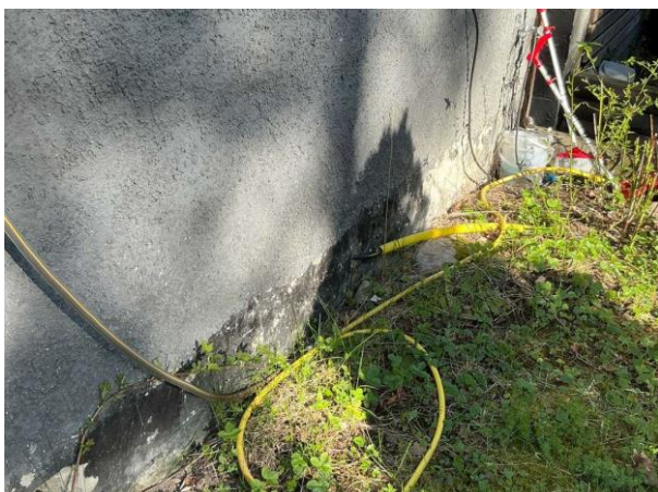
Bild 1: Utvändigt, Mark, Berget lutar in mot grunden vilket tillför ytvatten till grundem Marken runt huset har satt sig
