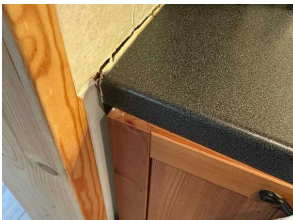
Bild 11: Invändigt, Entréplan, Kök, Tätt botten i diskbänkskåpen saknas, regler för modern köksmiljö rekommenderar att botten i diskbänkskåpen skall vara tät om det uppstår ett...
