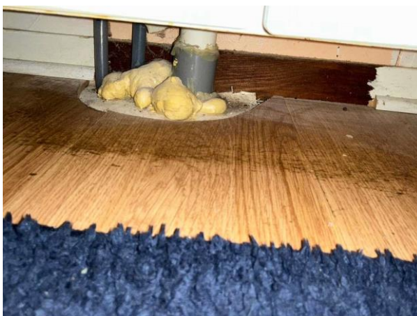
Bild 10: Invändigt, Entréplan, Wc, Toalett ej utförd med vattentätt golv med uppvik mot vägg Det förekommer rörgenomföringar i golv tätat med skum
