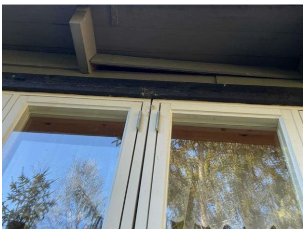
Bild 3: Utvändigt, Fasad, Lös panelbräda på veranda
