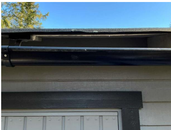
Bild 6: Utvändigt, Yttertak, Hängränorna bör riktas Mossa noterades på tak, mossor är fukthållande och kan orsaka skador på takkonstruktionen (rensa) Täckplåt vid skors...
