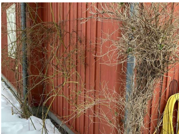
Bild 1: - Utvändigt, Fasad, Klängväxter noteras på fasaden ...
