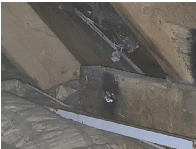
Missfärgningar och kondensutfällningar på vind.
