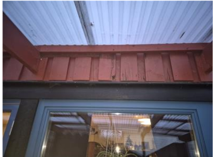
Rötskador i vägg under altantak.
