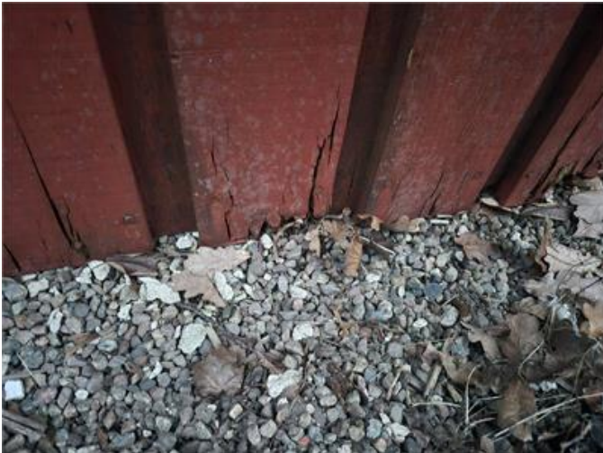
Rötskador i nedre del av vägg på baksidan av huset.
