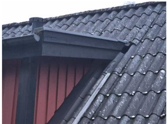
En eternitskiva sidan om takkupa på baksidan av huset, har delvis släppt vilket medfört att regnvatten runnit ner under taket. Om det medfört till fuktskador rekommenderas att undersökas vidare.
