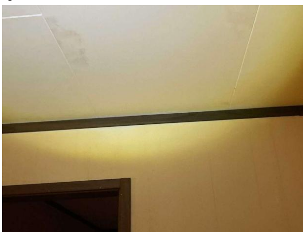
Bild 12: Invändigt, Övre plan, Missfärgningar noteras på innertaket
