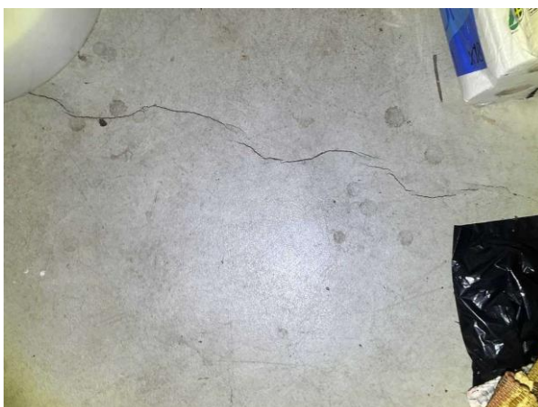
Bild 6: - Invändigt, Soutterrängplan, spricka noteras på betonggolvet
