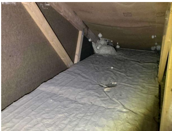
Bild 4: - Utvändigt, Vind, Getingbo noteras på vinden...
