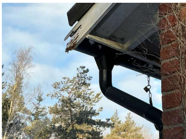
Bild 5: - Utvändigt, Yttertak, Rötskadade vindskivor på Äldre tak
