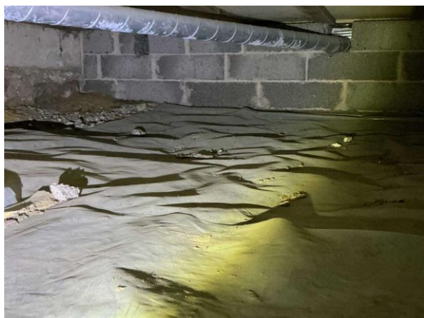
Bild 7: - Utvändigt, Grund, Utluftventilerad krypgrund är en känd riskkonstruktion,
