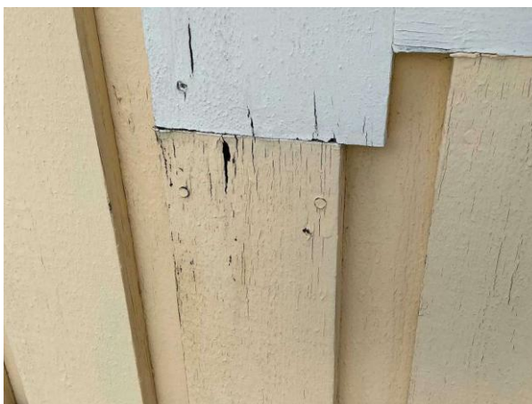
Bild 8: - Utvändigt, Fasad, Färgsläpp torrspäckor noterades på panelen. Lokalt noteras rötskada träpanel
