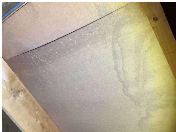
Bild 9: - Utvändigt, Vind, Lokalt noteras det mikrobiell påväxt samt fuktrosor på underlagstaket
