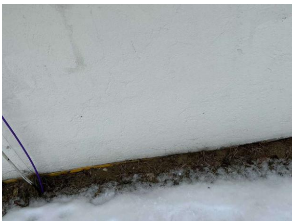
Bild 2: - Utvändigt, Grundmur/Hussockel, Lokalt noteras sprickor på grundmur
