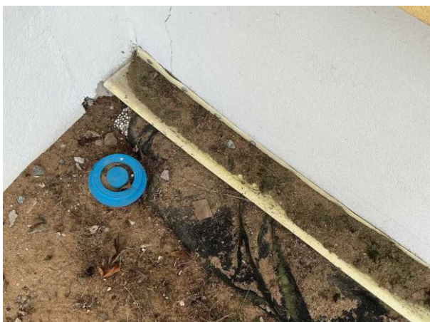
Bild 1: Utvändigt, Mark, Synlig och delvis otät dränering noteras ovan mark...
