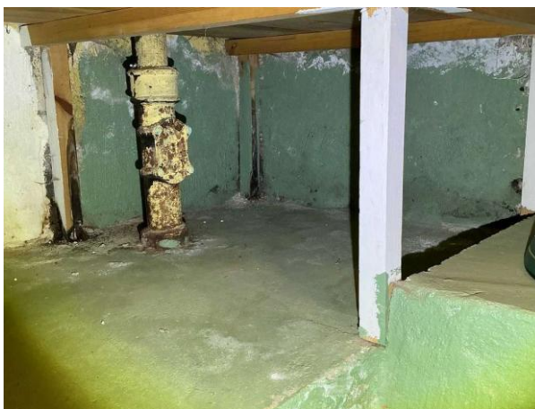
Bild 14: - Invändigt, Källarplan, Missfärgningar/fläckar ock sprickor noteras på väggar Rötskadade stolpar noteras till hylla
