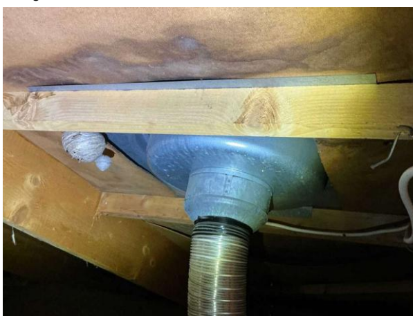
Bild 12: - Utvändigt, Vind, Lokalt noteras det mikrobiell påväxt samt fuktrosor på underlagstaket
