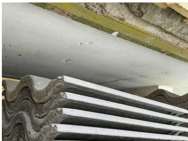
Bild 13: - Utvändigt, Balkong baksidan, Sprickor noteras på betongtrappan på baksidan Synlig armering noteras i underkant
