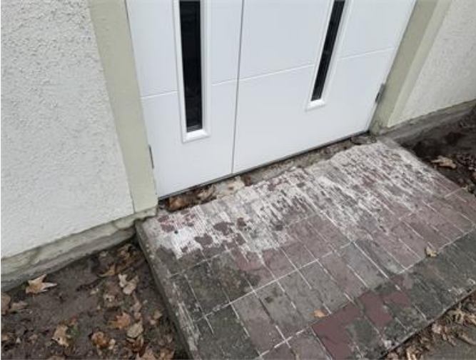
Otättheter mellan avsats och entrédörr.
