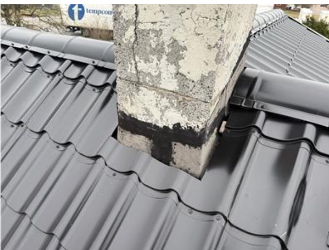
Sprickor i skorsten noterades samt otättheter mellan takbeklädnad och skorsten.
