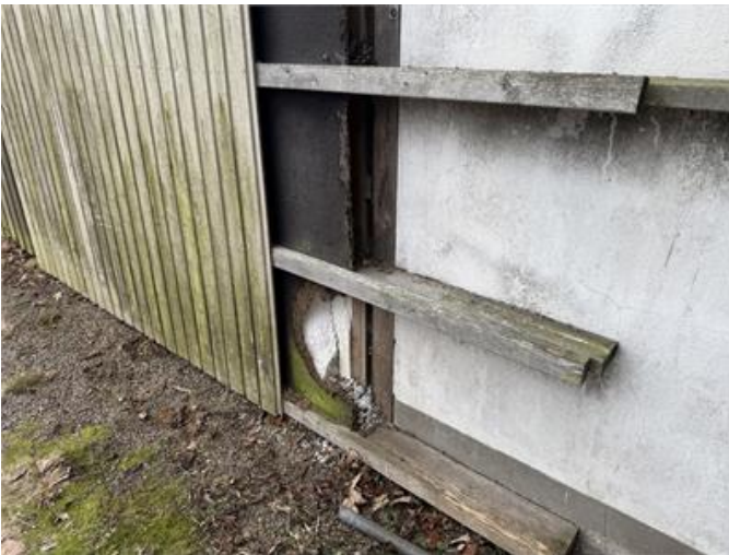
Vägg/fasad till förrådsdelen är inte färdigställd.
