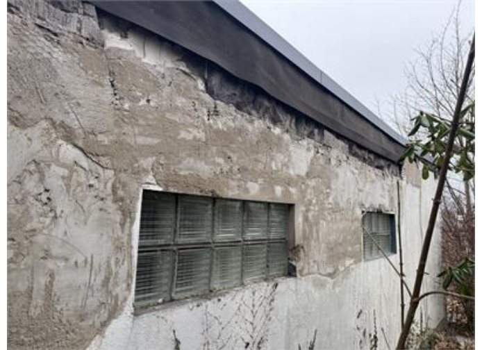
Putssläpp noterades på (bl.a.) sidobyggnadsdel. Otättheter förekommer också vid takfoten.
