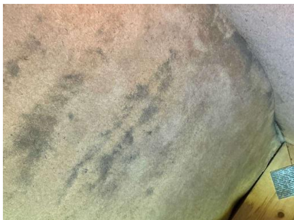
Bild 1: Utvändigt, Vind, Mikrobiell påväxt på nderlagstaket
