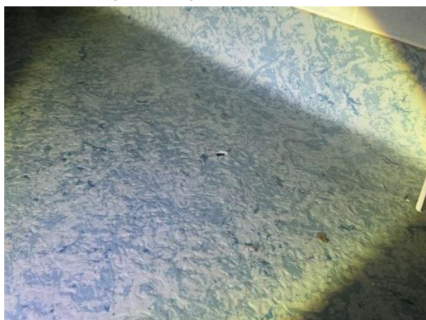
Bild 5: - Invändigt, Övervåning, Äldre våtrum Klämringen är inte nedtryckt mot golvbrunnen Skador noterades i plastmattan
