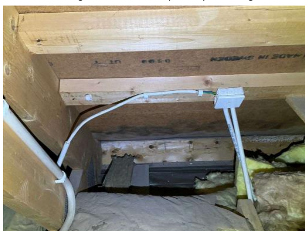
Bild 3: Invändigt, Övervåning, Lokal mikrobiell påväxt noterades i takfot samt vid genomföring
