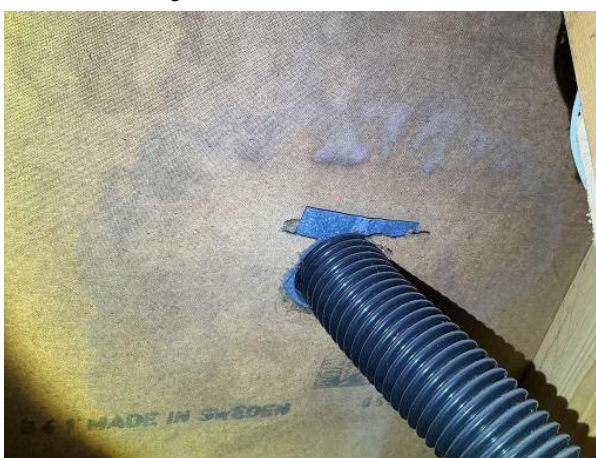
Bild 4: Invändigt, Övervåning, Lokal mikrobiell påväxt noterades i takfot samt vid genomföring
