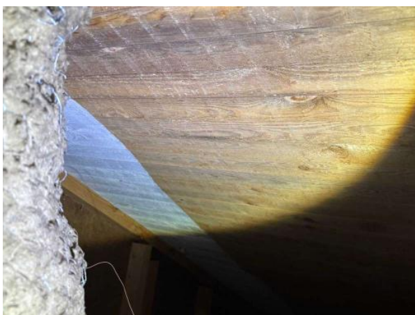
Bild 2: - Utvändigt, Vind, Lokal mikrobiell påväxt noterades vid en genomföring
