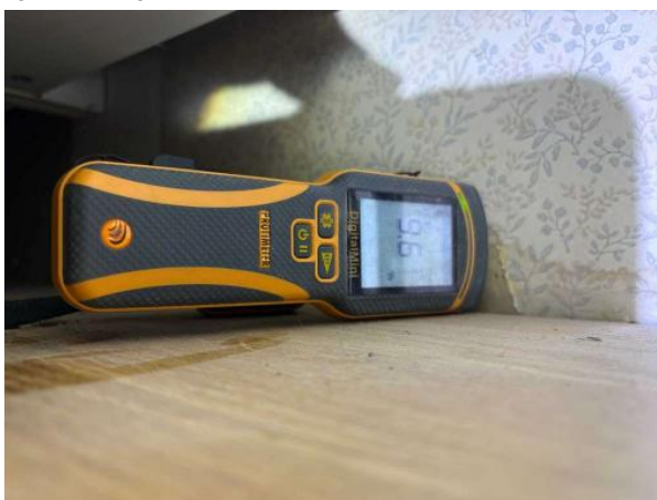
Bild 4: - Invändigt, Entreplan, Fuktfläck noterades på vägg under kylskåpet, torrt vid besiktningstillfället.
