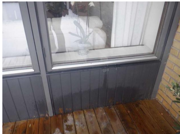
Bild 4: Kondensvatten från luftvärmeaggregat fuktpåverkat fasad.
