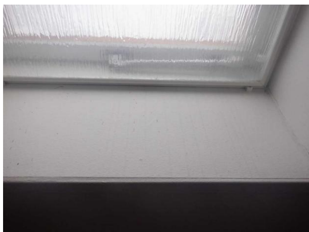
Bild 9: Rinningsmärke invid takfönster.
