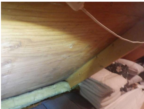
Bild 12: Mikrobiell missfärgning, takfotsventilation igensatt.
