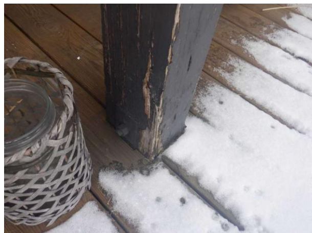
Bild 6: Slitage på stolpe till balkong.
