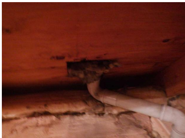
Bild 11: Spår efter fuktgenomsläpp, vind.
