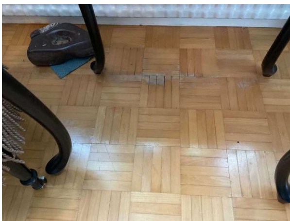
Bild 16: - Invändigt, Entréplan, Fläckar och missfärgning noteras lokalt på golvet på ett par ställen (Torrt vid besiktningsstillfälet).
