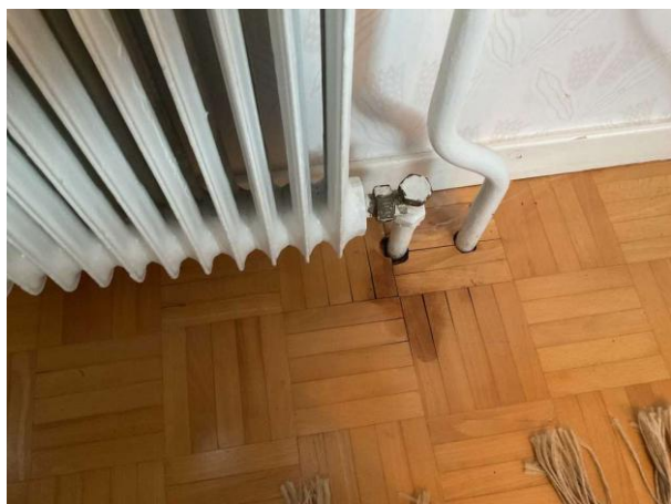
Bild 15: - Invändigt, Entréplan, Fläckar och missfärgning noteras lokalt på golvet på ett par ställen (Torrt vid besiktningsstillfälet...
