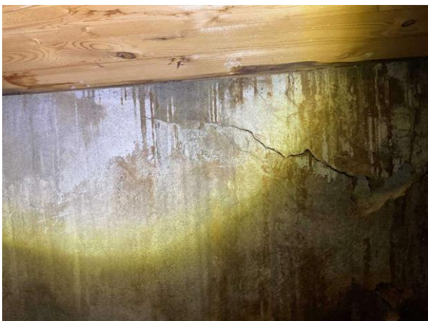
Bild 5: - Utvändigt, Vind, Lokalt på vinden noteras det mikrobiell påväxt samt fuktrosor på underlagstaket, putssläpp noteras på skorstenen
