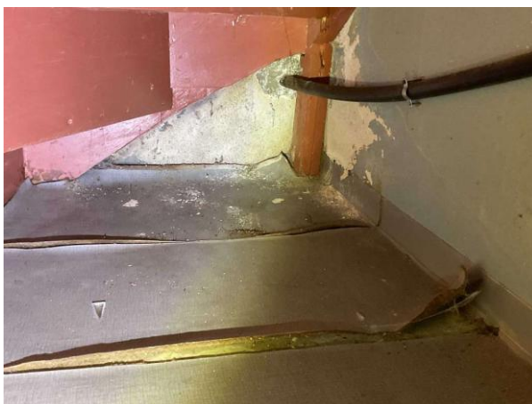
Bild 8: Invändigt, Källarplan, Putssläpp noteras på väggar
