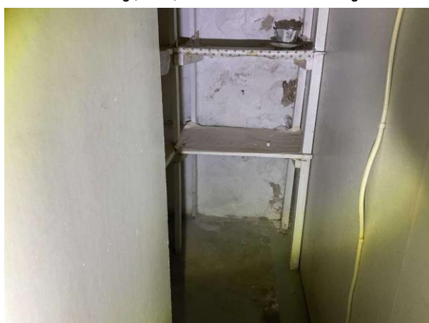
Bild 9: Invändigt, Källarplan, Putssläpp noteras på väggar
