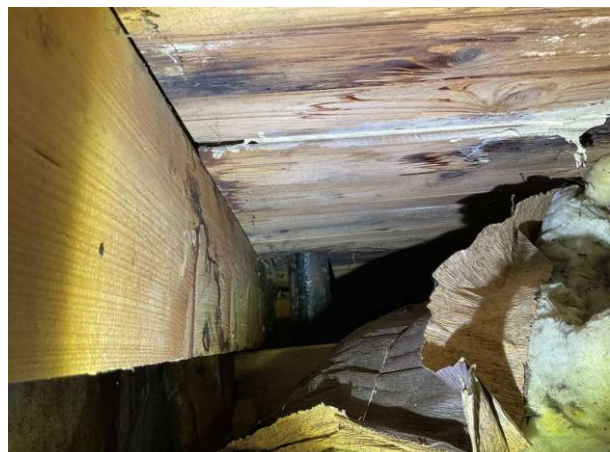
Bild 6: - Utvändigt, Vind, Lokalt på vinden noteras det mikrobiell påväxt samt fuktrosor på underlagstaket
