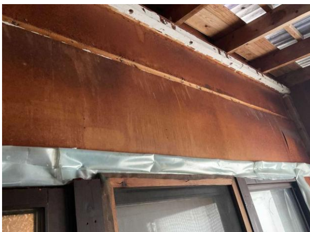
Bild 1: - Utvändigt, Fasad, Fasad panel saknas på altanvägg...
