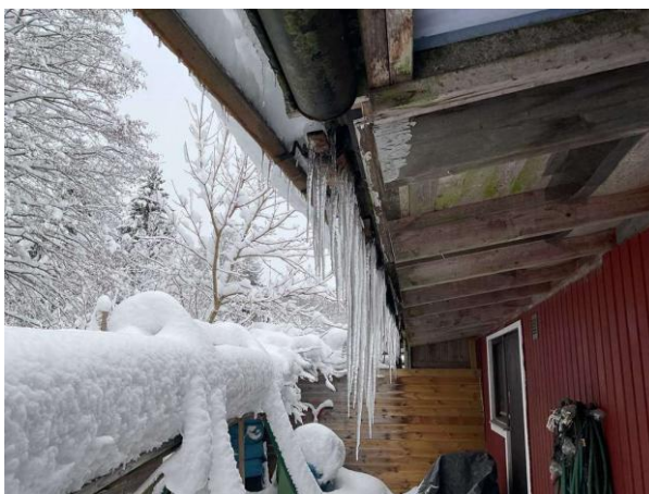
Bild 8: - Utvändigt, Yttertak, Hänggrännor saknas
