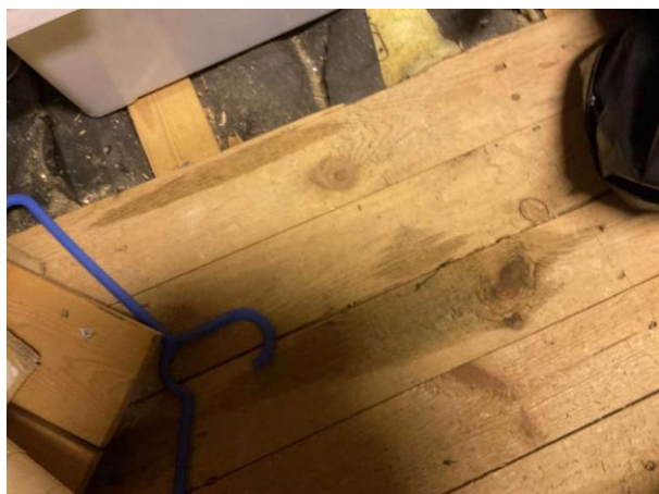
Bild 7: - Utvändigt, Vind, Lokalt noterades fläckar på vindsbjälklagsgolvet
