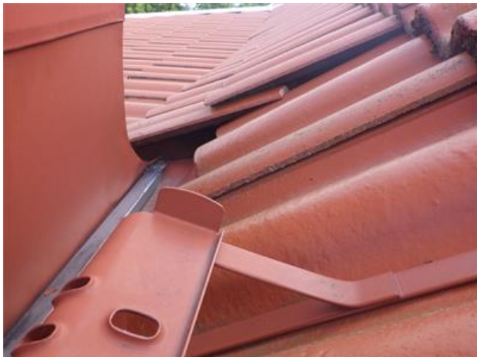
Takpannor i fel läge.
