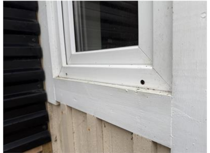
Det förekommer fönster utan undre fönsterbleck.
