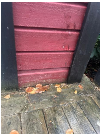
Delvis är fasaden för nära altantrallen.
