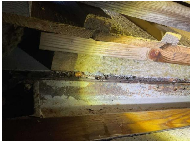
Bild 4: - Utvändigt, Fasad, Färgsläpp noteras på panelen Äldre rötskadad panel noteras bakom ny panel, (oklar uppbyggnad)
