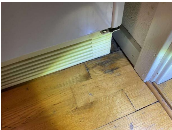
Bild 8: Invändigt, Entréplan, Missfärgning och svällskada noteras vid kyl/frys
