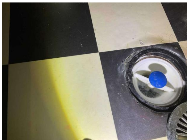
Bild 7: - Invändigt, Entréplan, Äldre våtrum med plastmatta på golvet Klämringen i golvbrunnen är lös, hål noteras i plastmattan vid golvbrunnen
