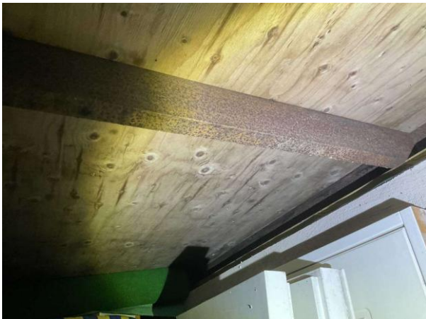
Bild 3: - Utvändigt, Grund/förråd, Uteluftventilerad kryppgrund Missfärgningar och mikrobiellpåväxt noteras lokalt på golvbjälklagsskivorna
