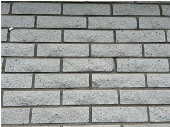
Spricka i fasad.
