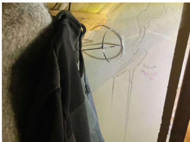
Bild 7: - Invändigt, Övervåning, Fuktrosor noteras på väggen som är inringade
