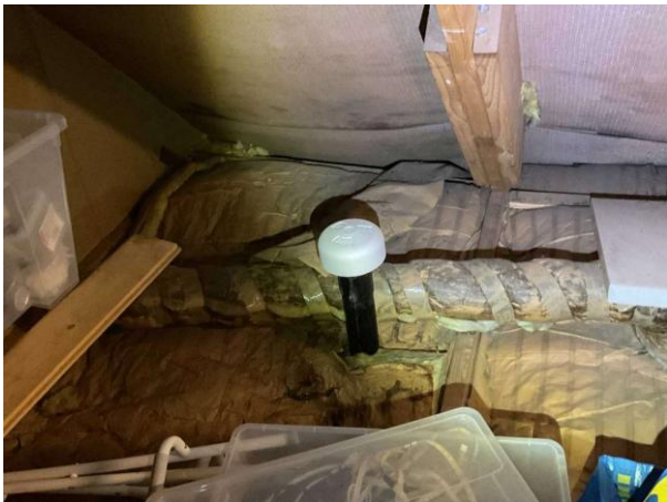
Bild 1: - Utvändigt, Vind, Avluftningen från avloppet avslutas på vinden (bör avslutas)
