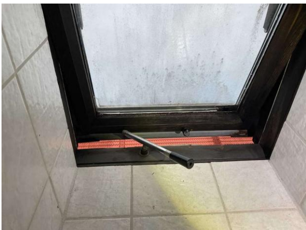
Bild 5: - Invändigt, Övervåning, Bedöms som äldre våtrum Missfärgningar noteras på takfönster Bristfälligt tätat mellan takfönster och kakel
