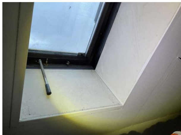
Bild 6: Invändigt, Övervåning, Rinnmärken noteras vid äldre takfönster med färgsläpp på fönsterkarm
