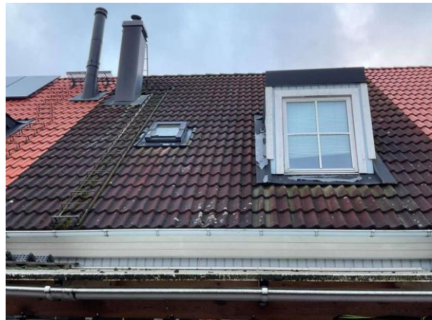
Bild 4: - Utvändigt, Yttertak, Äldre tak med takfönster och takkupor Mossa noteras på takpannorna Äldre takplåtar med färgsläpp...
