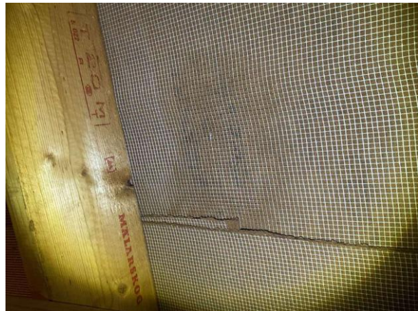
Bild 2: - Utvändigt, Vind, Fuktrosor noteras på underlagstaket av board/masonite
