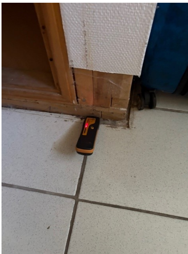
Fuktmätning i nedkant av träregel till bastun.
