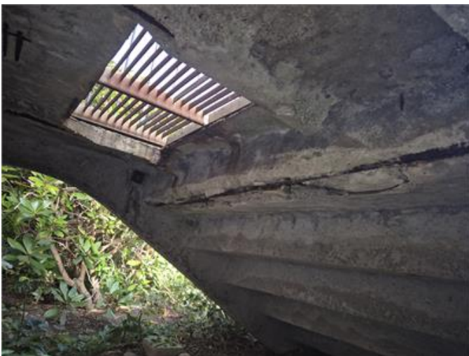
Betongskador förekommer i entrétrappa på grund av rostangripen armering.
