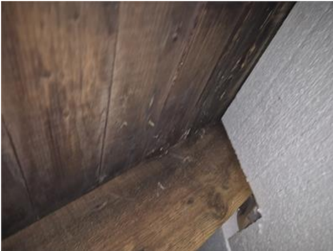
Rötskadad svall, sidvind.
