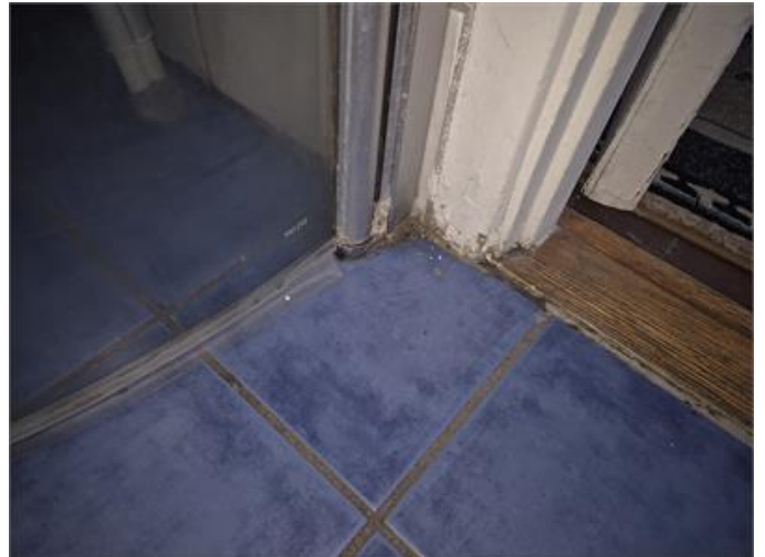
Fuktpåverkad dörrkarm/foder i dusch.
