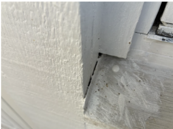
Fasad: bilden visar exempel på otäthet vid fönsterbleckets uppvik.
