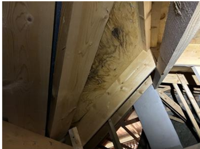
Nockvind: Missfärgningar noterades lokalt på underlagstaket under uttertaket räknad.
