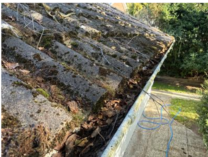
Hängrännor, Tak: Mossa förekommer på taket, särskilt på sida åt söder. Hängrännor på södersida är fulla med skräp, behov av rensning.
