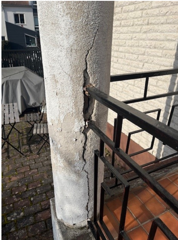
Sprickor i bärande pelare till balkong.
