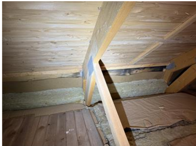
Spår av läckage i underlagstak på vind
