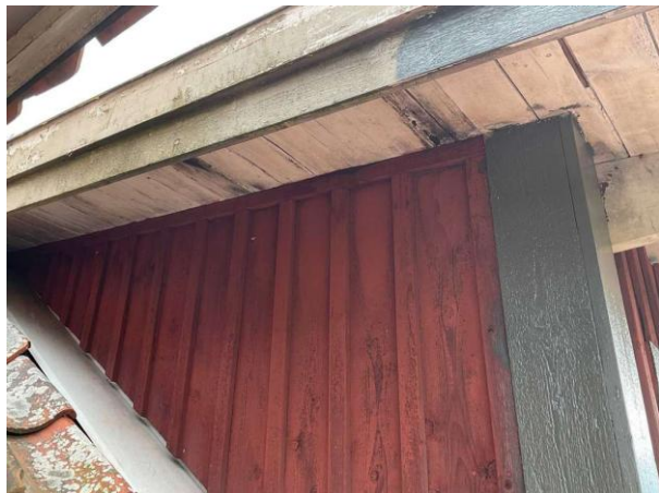
Bild 4: - Utvändigt, Yttertak, takkupor med färgsläpp/rötskador på takfotssprånget...
