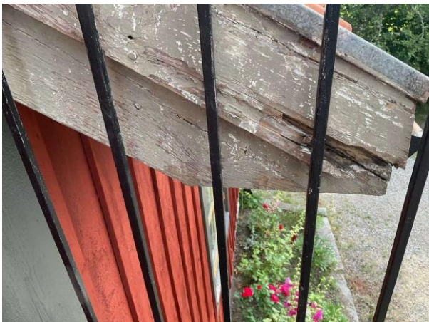
Bild 3: - Utvändigt, Yttertak, Rötskadade vindskivor...
