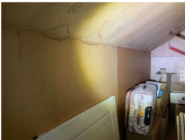
Bild 32: Invändigt, Övervåning, Fuktbläckar noteras på boardskivorna i båda vindarna
