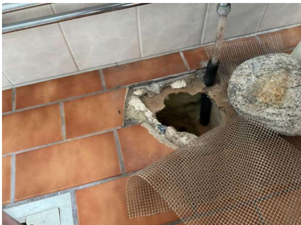
Bild 22: - Invändigt, Entréplan, Äldre våtrum Det finns ett hål i golvet ner till grunden, renovering rekommenderas innan användning av utrymmet
