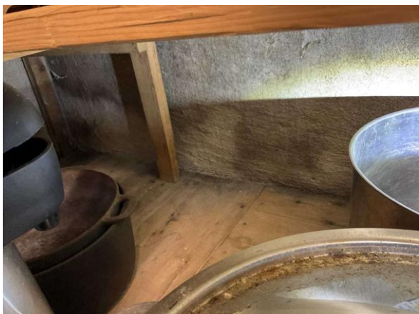
Bild 15: Invändigt, Källare, Färgsläpp noteras på vägg och golvet
