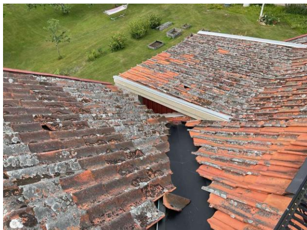
Bild 6: - Utvändigt, Yttertak, Takpannor saknas med synlig läkt
