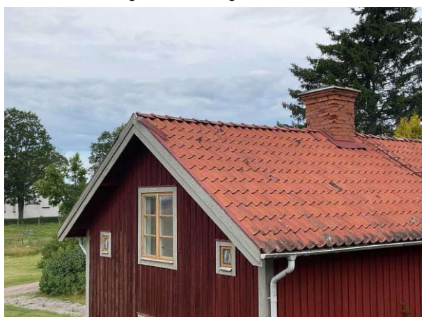
Bild 27: - Utvändigt, Yttertak, Äldre tak Frostsprängt tegel noteras
