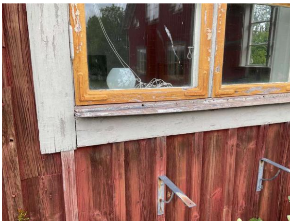
Bild 26: Utvändigt, Fönster, Torrprickor noteras på äldre fönster
