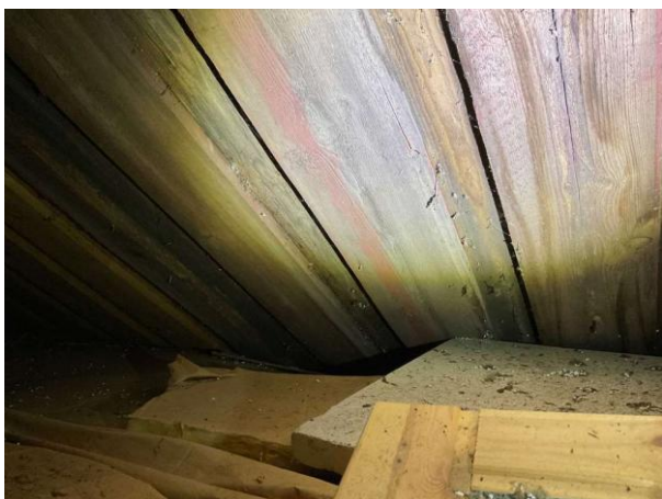
Bild 20: - Utvändigt, Vind, Huset är självdragsventilerat lokalt noteras mikrobiell påväxt på underlagstaket
