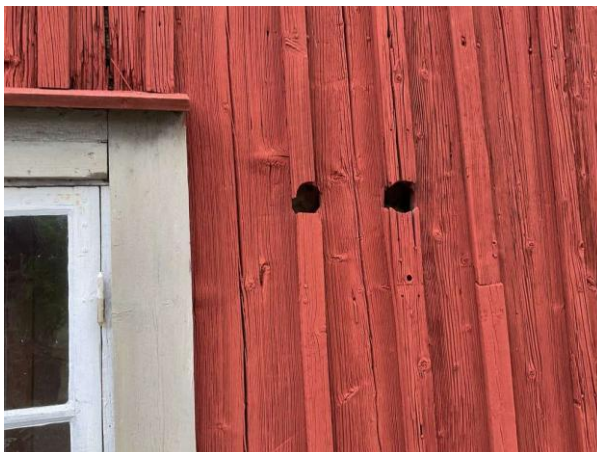
Bild 17: - Utvändigt, Fasad, Hål noteras i fasaden
