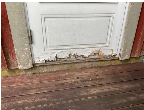
Bild 19: Utvändigt, Ytterdörr, Ålanddörr som är rötskadad och saknar tröskelplåt
