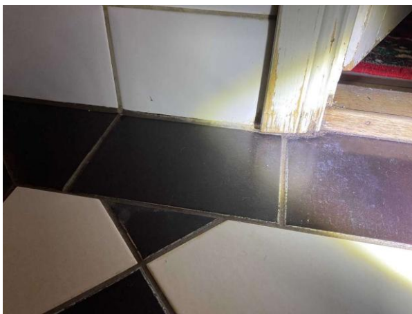
Bild 10: - Invändigt, Entréplan, Färgsläpp noteras i nederkant på dörrkarmen och foder
