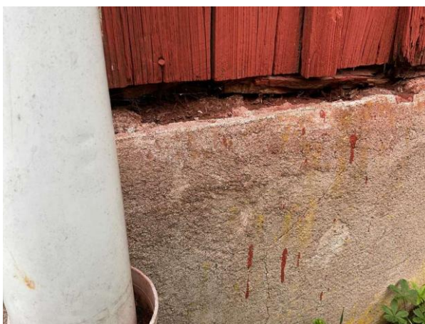
Bild 24: - Utvändigt, Fasad, Synlig träsyll noteras...
