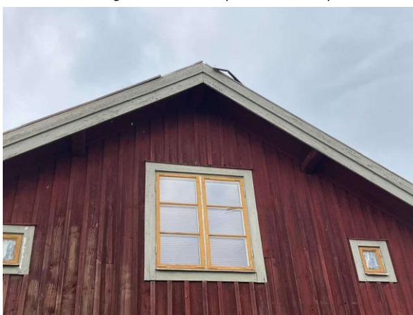
Bild 28: - Utvändigt, Yttertak, Äldre tak vindskiveplåt saknas på del av tak...
