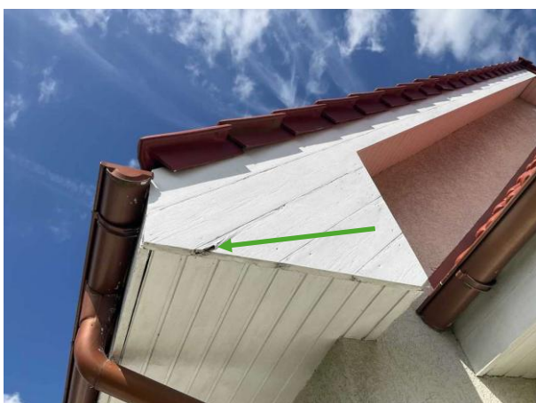
Bild 3: Utvändigt, Fasad, Torsprickor och färgsläpp förekommer på panel, med risk för röta i virket. Röta noterades vid stickprovskontroll.
