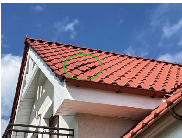
Bild 6: Utvändigt, Yttertak, Vissa takpannor ligger ej i rätt läge ovan takkupan.
