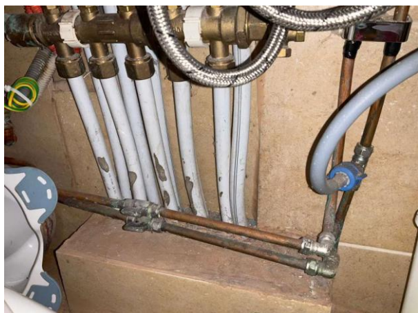
Bild 7: Invändigt, Entréplan, Rörgenomföringar förekommer i golv men har placerats på en klack. Rören har på vissa delar även monterats närmre vägg än gällande branschregler, vilket troligtvis är orsak till att kakelplatta har behövt monteras längre bak.
