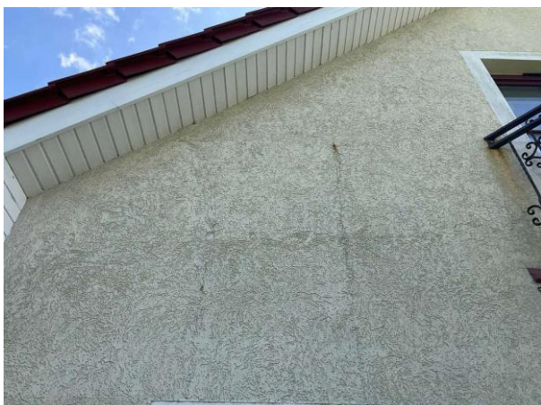
Bild 1: Utvändigt, Fasad, Finns sprickbildningar på vissa delar av putsad fasad, samt rostutfällningar.
