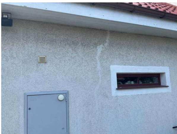
Bild 2: Utvändigt, Fasad, Finns sprickbildningar på vissa delar av putsad fasad, samt rostutfällningar.
