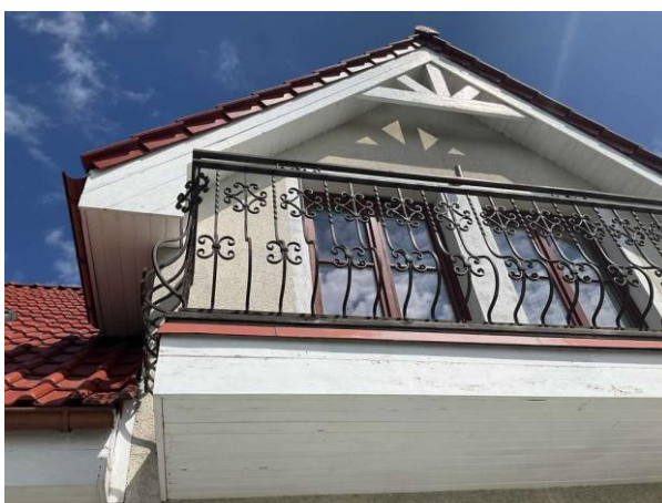
Bild 4: Utvändigt, Fasad, Torsprickor och färgsläpp förekommer på panel, med risk för röta i virket. Röta noterades vid stickprovskontroll.
