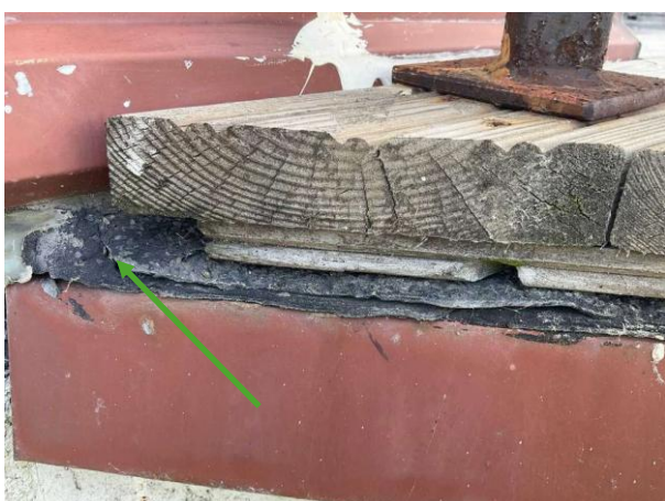
Bild 5: Utvändigt, Balkong, Noterades sprickbildning på den av takpapp i hörn av balkong på gavel.
