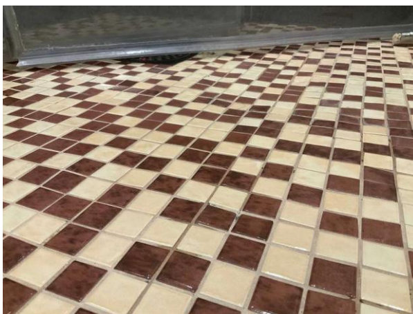
Bild 8: Invändigt, Entréplan, Finns ojämnheter på mosaikplattor vid duschplats.
