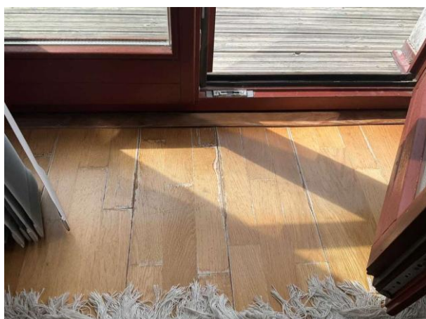
Bild 9: Invändigt, Ovanplan, Golvbeklädnad mot balkongdörr har skadats.
