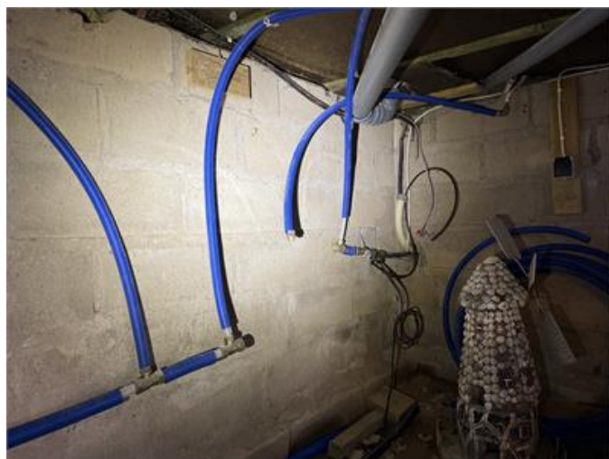
Exempel på oisolerade tappvattenledningar
