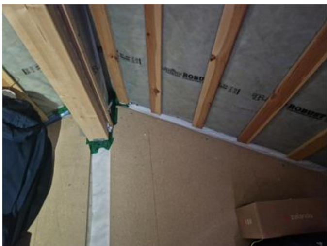
Bild pånockvind och oskyddad plastfolie
