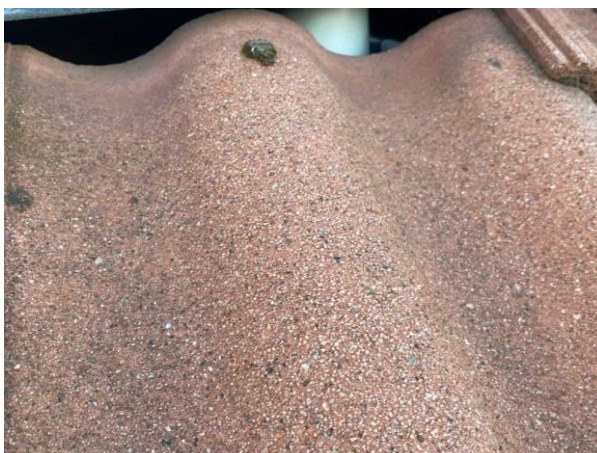
Bild 2: Utvändigt, Yttertak, Plåten till luftningen till avloppet är inte tät mot taket
