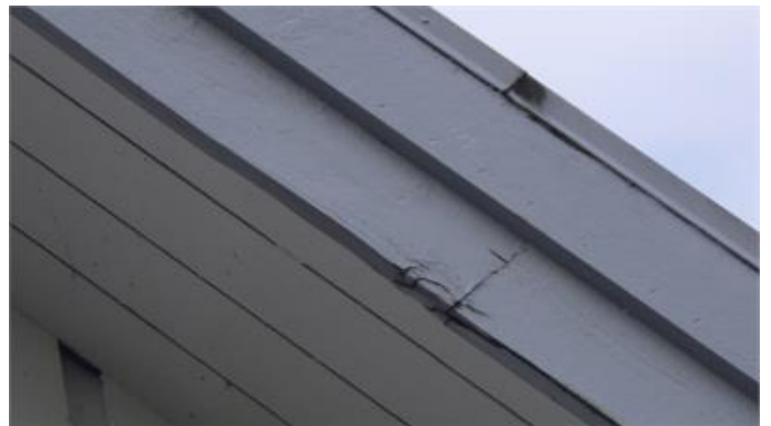
Rötskada i vindskiva
