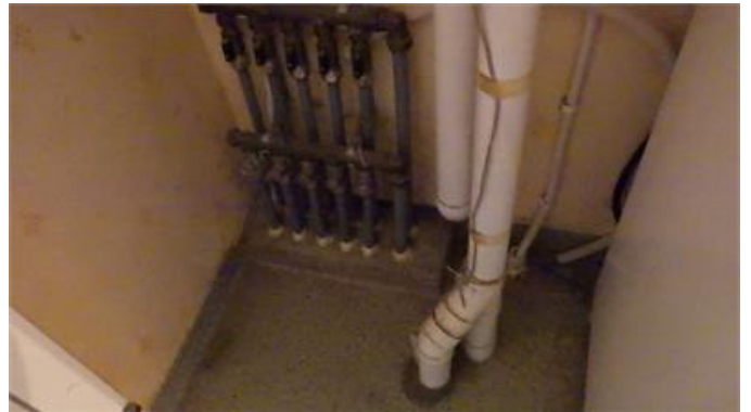
Rör genomföring i våtrumsgolv
