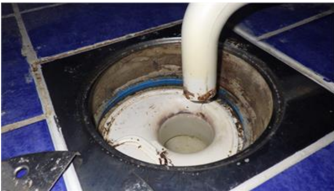
Golvbrunn där inte brunnsmanschetten är synlig
