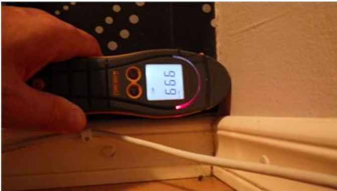
Hög fuktindikation på källarvägg
