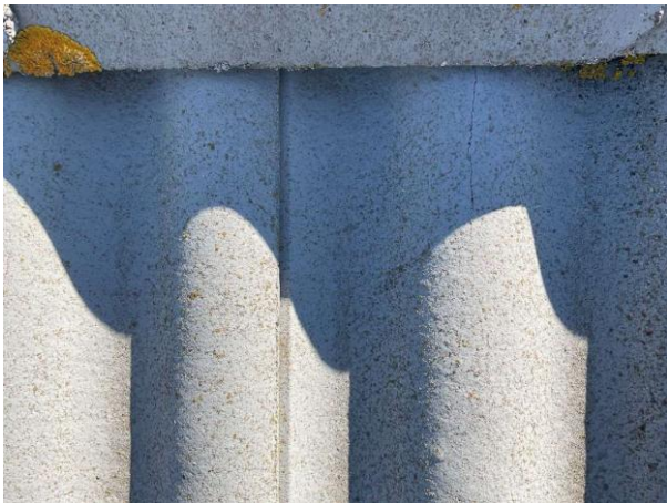
Bild 3: Utvändigt, Yttertak, Taket är begränsat besiktat i anslutning till taksäkerhet. Sprickor noteras i takpannorna...
